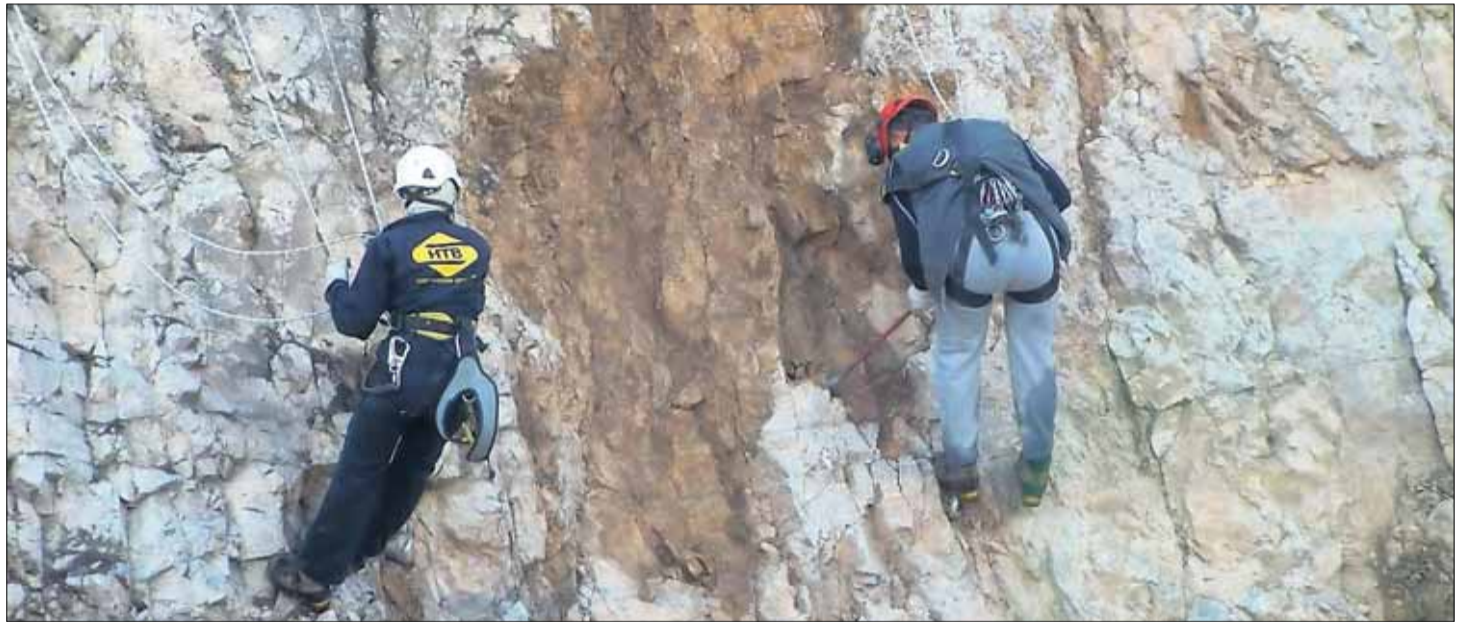
Beschädigte Steinschlagschutzgitter müssen noch repariert und der dort gelagerte Schnee entfernt werden. Ebenso werden die Felswände entlang der Mendelpassstraße von losem Material gesäubert (im Bild).
