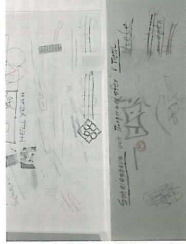
Schmierereien: Auf den Wänden der Toiletten
